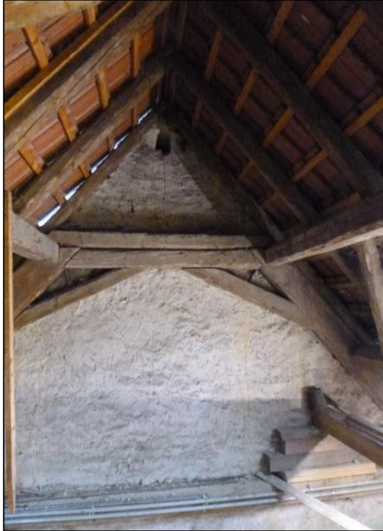
Abbildung 4: Dachstuhl einer alten Scheune im Hinterhof der Nr. 8 auf dem Flurstück 231 ohne Besiedlungsspuren v. Schleiereule oder Turmfalke (Foto: F. Kurz)
