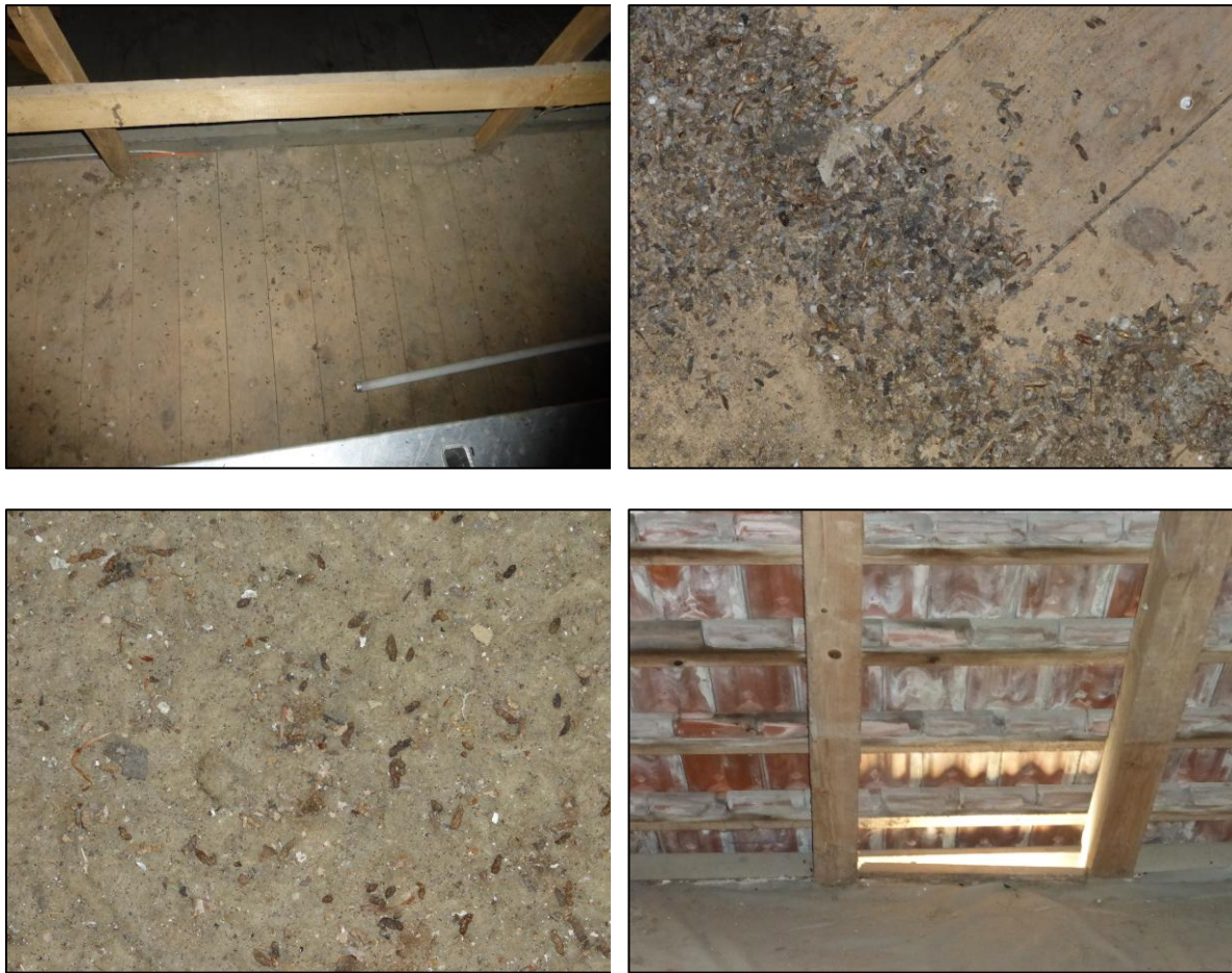
Abb. 4: Verteilung des Fledermauskots und Einflugmöglichkeit in den Dachinnenraum
